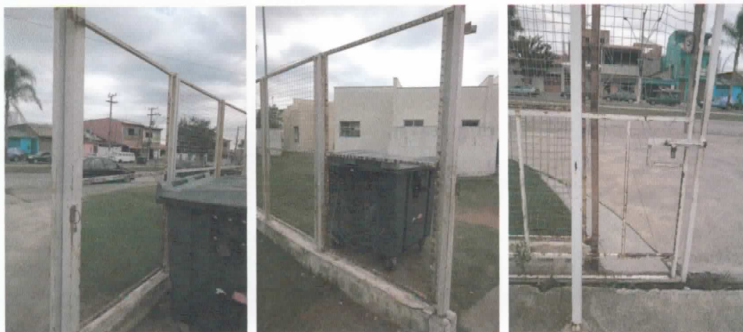
Figura 4 – Escola Pública municipal de Sorocaba com alambrados depredados no mês de Maio/2018. Foto de Agosto/2018. Risco iminente de danos físicos, além de risco de invasão.
