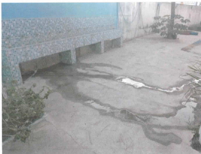
Figura 3 – Vazamento em Escola Pública municipal de Sorocaba. Agosto/2018. Risco iminente de danos físicos, além de prejuízo ao erário público.
