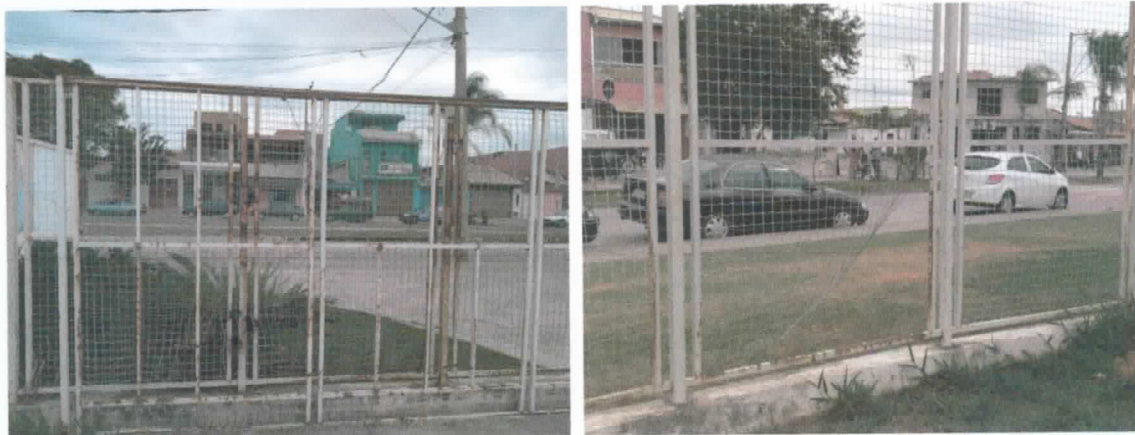
Figura 5 – Escola Pública municipal de Sorocaba com alambrados depredados no mês de Maio/2018. Foto de Agosto/2018. Risco iminente de danos físicos, além de risco de invasão.
